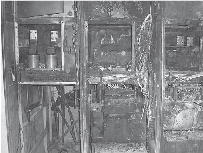
Figura 3: Painel elétrico após curto circuito.
