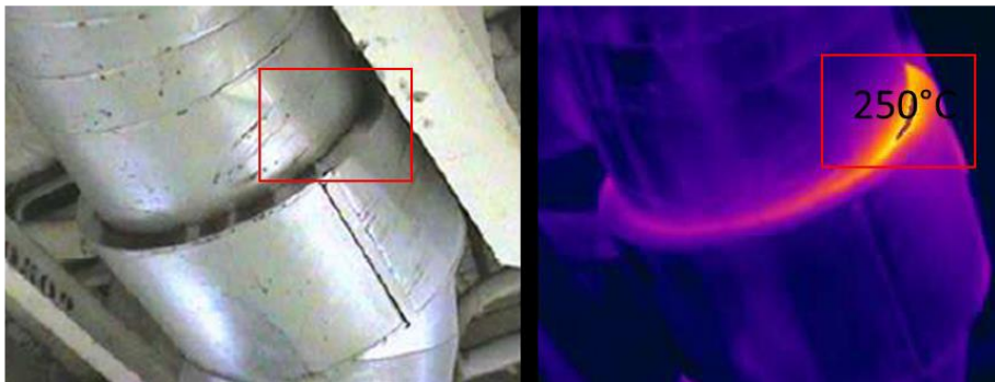
Figura 20: Exemplo de inspeção termográfica que não atende ao requisito SOLAS, com temperatura acima de 220°C em flange da linha de exaustão, com ponto quente na interface de transição entre isolamento térmico.
