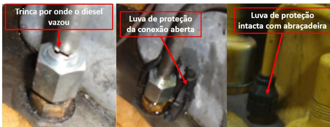
Figura 10: Luva de proteção em conexão de tubulação de óleo diesel instalada incorretamente gerando incêndio após quebra de conexão.
