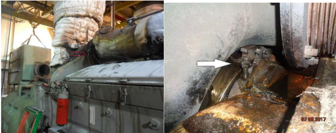
Figura 29: Local e parte da turbina danificada levando ao princípio de incêndio.
