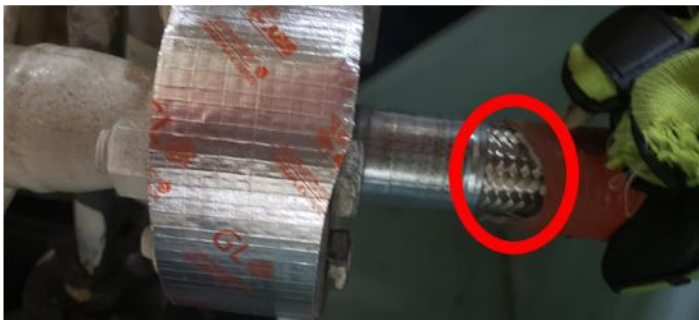
Figura 16: Verificação de integridade das proteções de mangueiras.
