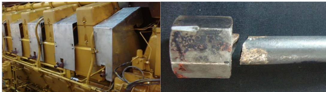
Figura 9: Proteção instalada para evitar spray por quebra em tubulação de diesel.
