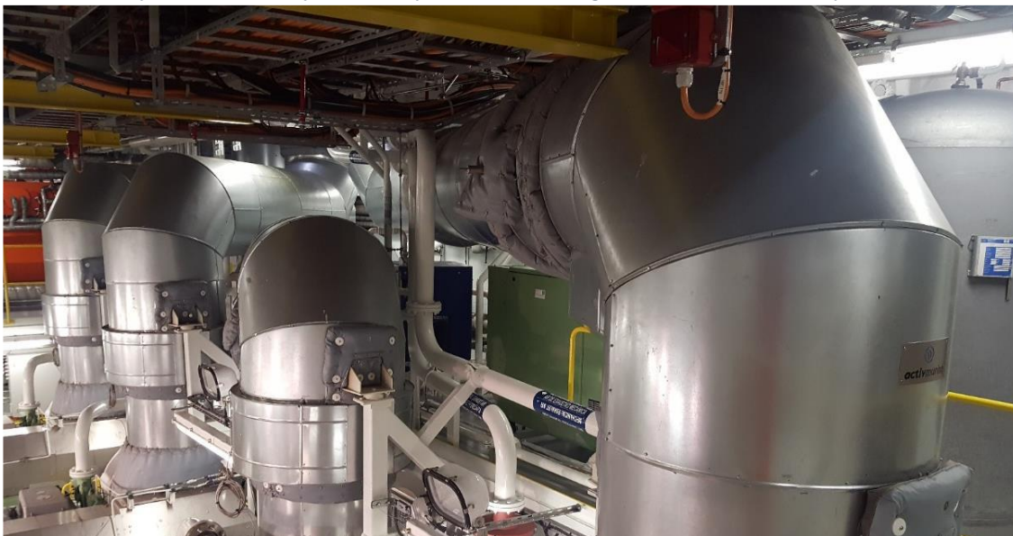
Figura 25: Linha de exaustão completamente vedada em conexões entre seções e curvas, sem possibilidade de ingresso de óleo diesel/lubrificante.
