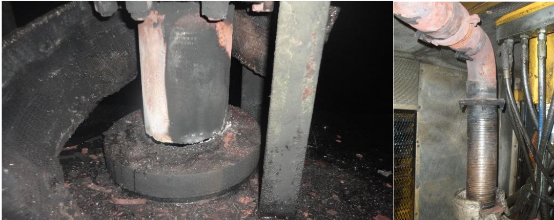
Figura 27: Linha de exaustão acima do piso acima da sala de máquinas do guindaste e linha de exaustão do motor no compartimento de máquinas do guindaste.
