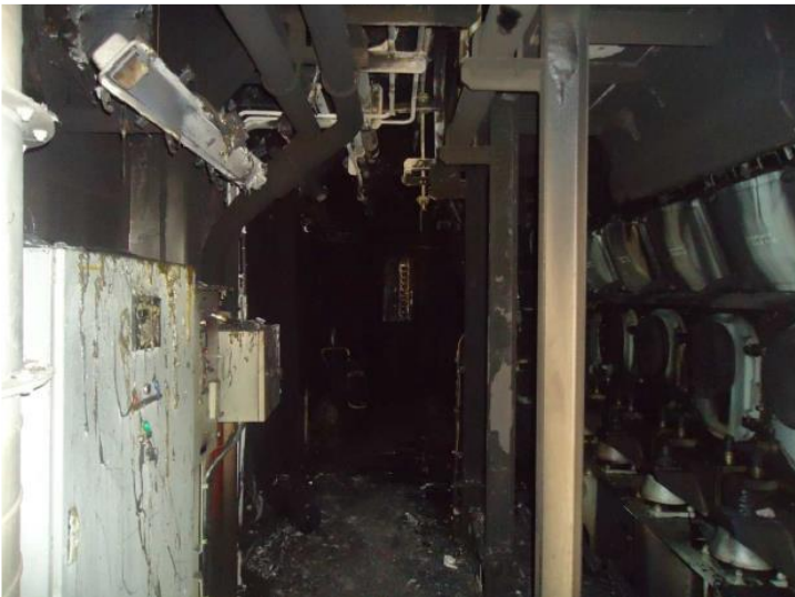
Figura 2: Sala de máquinas após incêndio devido a vazamento de combustível.
