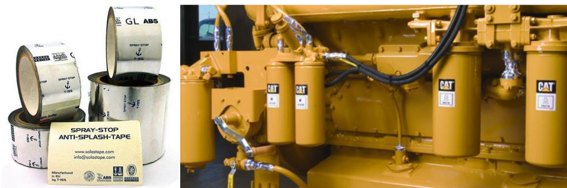
Figura 14: Fita anti-spray adequadamente instalada em conexões pressurizadas dos motores.
